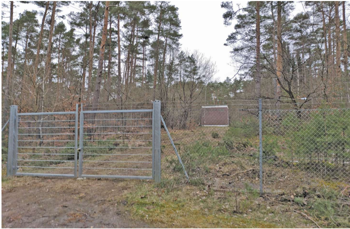
Geschützt mit Schloss und Stacheldrahtzaun: Die zwei Brunnen bei Lindwedel liegen nördlich der Ortschaft. Dort werden im Jahr im Maximum acht Millionen Kubikmeter Wasser gefördert. Fotos: Scheele
