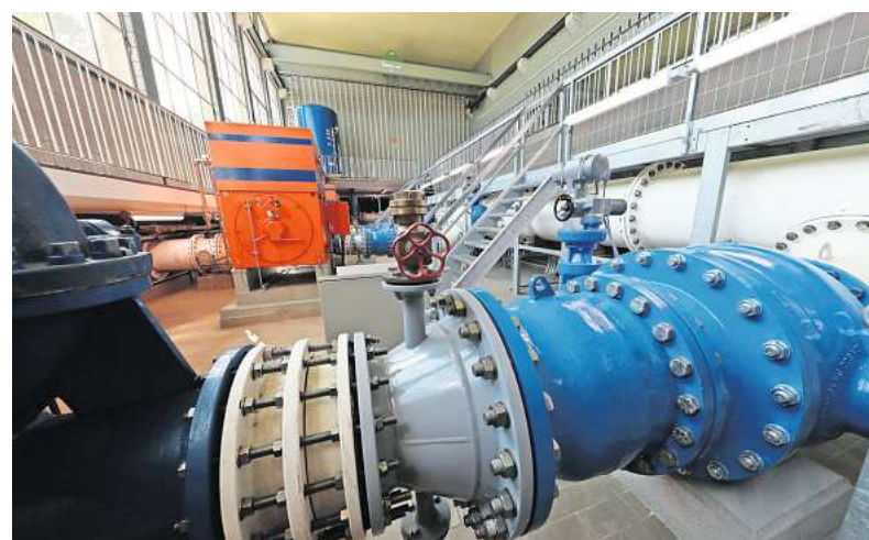
Dicke Rohre: Aus dem Wasserwerk Fuhrberg fließt Wasser nach Hannover und in Teile der Region. FOTO: RAINER DRÖSE
